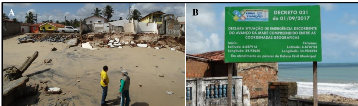
Figura 1. A. Rua Dom Pedro II, na cidade de Baía da Traição-PB, mostrando degradação das residências devido ao avanço do mar; B. e a placa indicatória de interdição da área (Fotos: Luis Gustavo, 2017).
